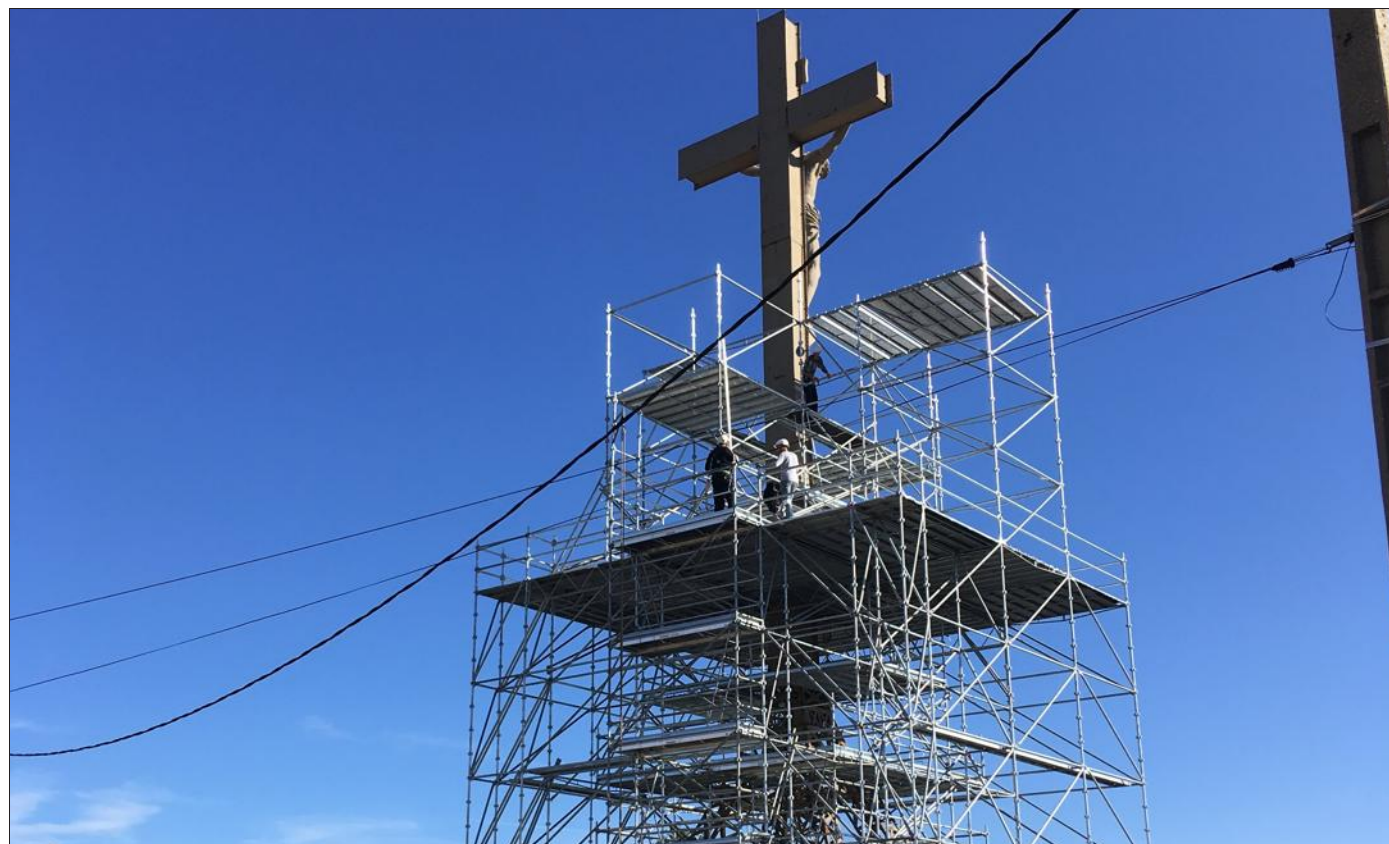
Les travaux de restauration de la Croix-de-Mission sont en cours. Photo Progrès/Pascale BIGAY
